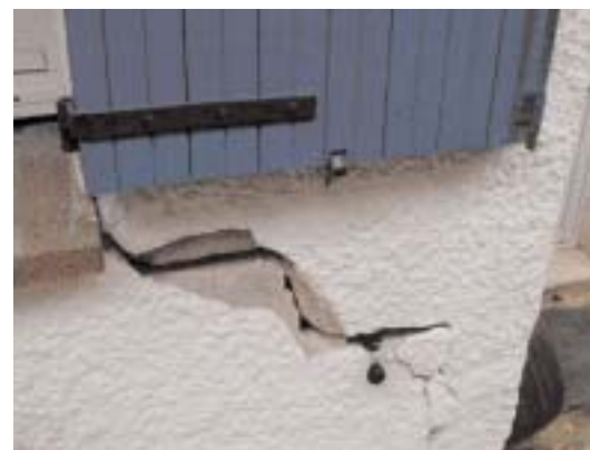
Photo 2 : Exemple de maison fissurée – Example of a cracked house. Source : BRGM
