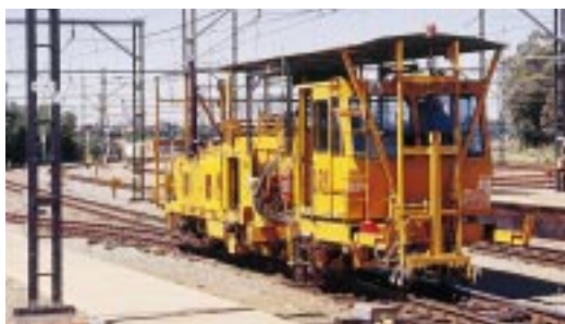
La maintenance de la voie est l'objet d'importantes recherches à Spoornet. Track maintenance: A major field of research at Spoornet.
